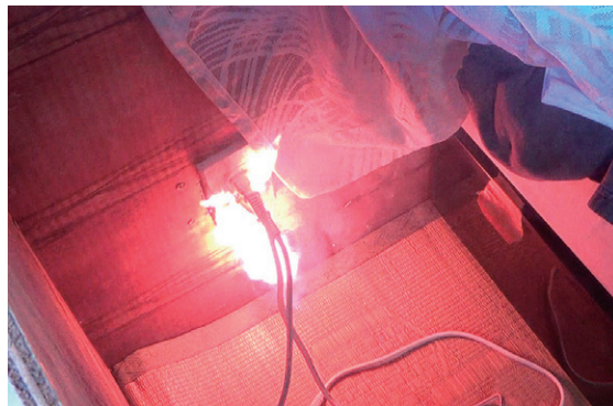
トラッキング現象により出火
